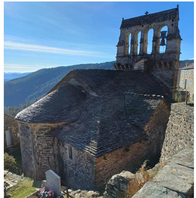
L'humidité était très présente dans l'église. Une solution a été trouvée via le dispositif "Humi-Stop".
